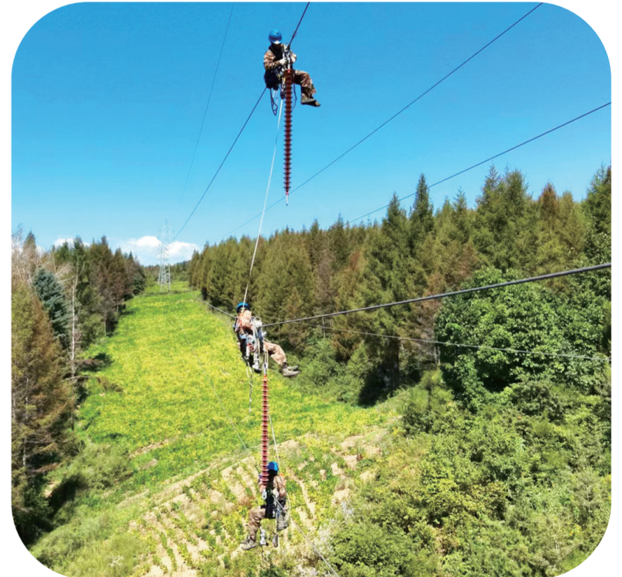
▶项目建设,电力先行。国网白山供电公司通过各种技术手段增强电网抗击自然灾害能力,提升供电可靠性,为经济发展提供安全稳定电力。赵洪涛 摄
