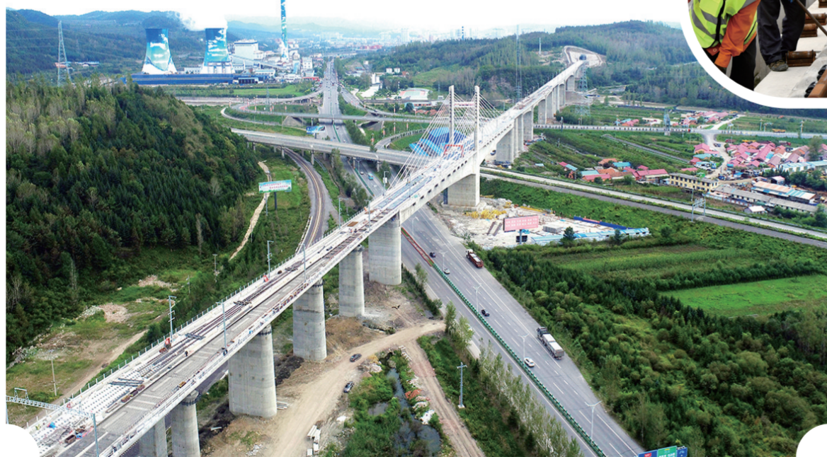
初秋时节,中铁上海工程局沈白高铁吉林段TJ-5标项目部建设工地上,1000多名建设者抢工期、保进度,全力推进工程建设。图为建设中的白山洋江特大桥。徐孝忠 摄
